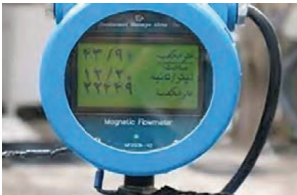
شکل ۴ - کنتورهای هوشمند، راهی برای اندازه‌گیری و کنترل برداشت از چاه‌ها
