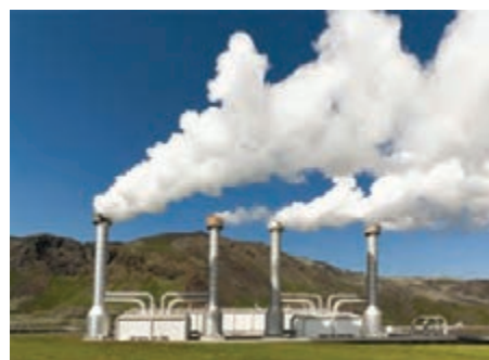
شکل ۱۱-۶- نیروگاه زمین گرمایی مشکین شهر - اردبیل
