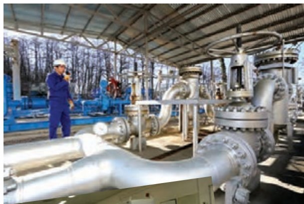
منطقه شمال - ایستگاه فشار شکن لاجیم
